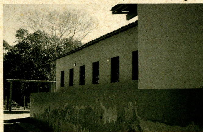
Construção às pressas causou a interdição da escola
